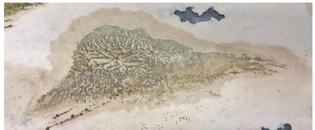
Õlikahjustus värvilaikude ümber.
